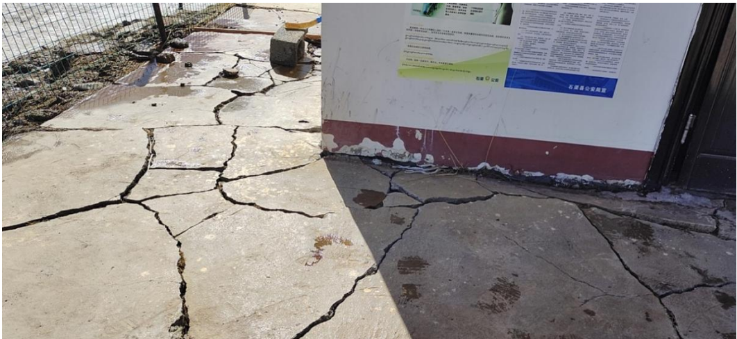
图 7、地面破裂严重
