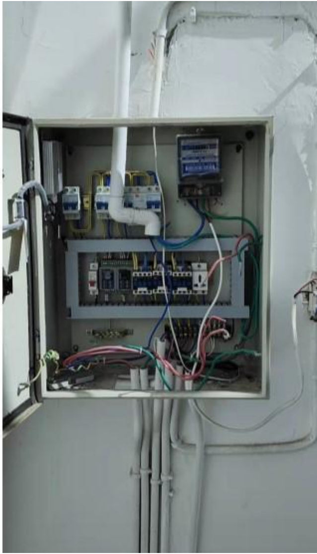
图 6、电源线及开关控制柜
