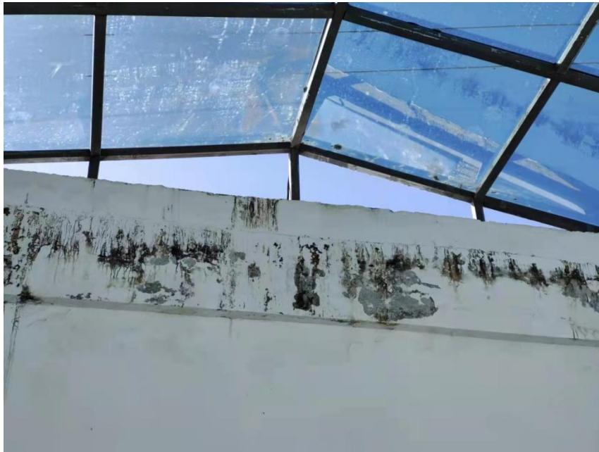
图 4、建筑物墙体受潮脱落
