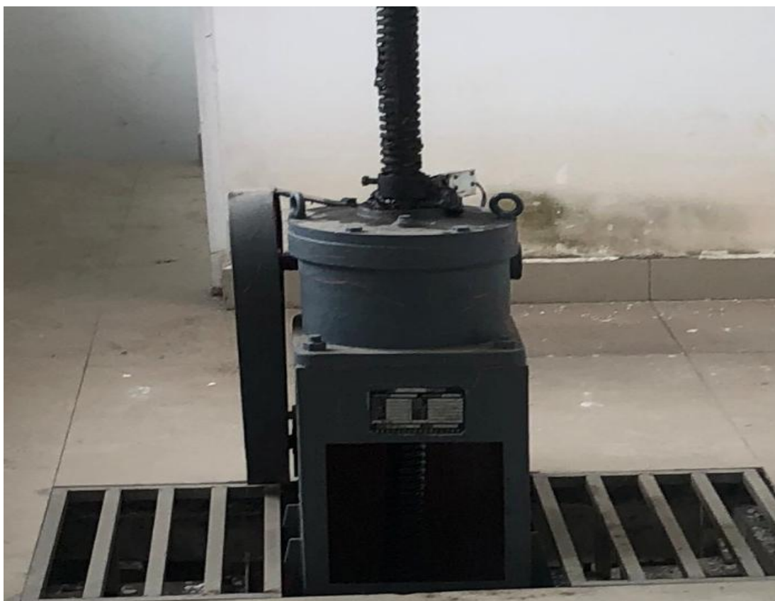
启闭设备现状
