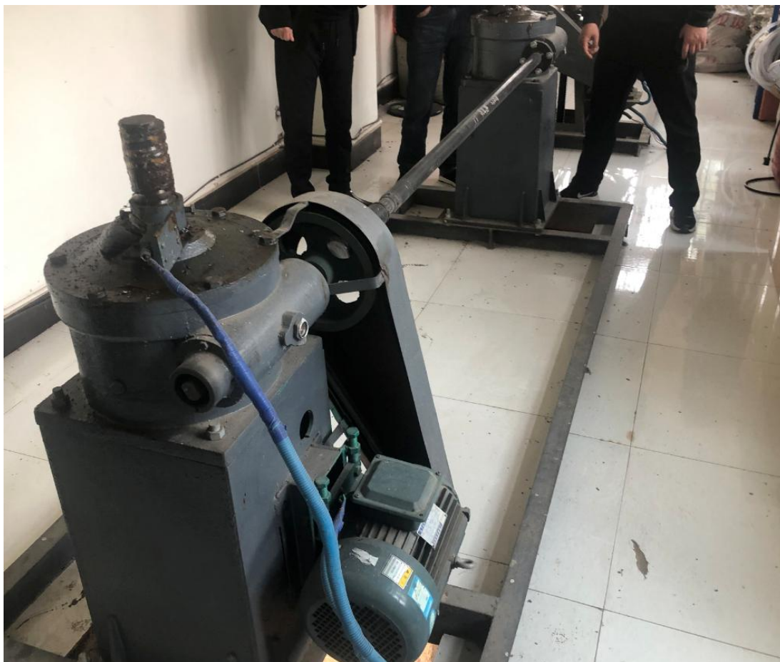
启闭设备现状
