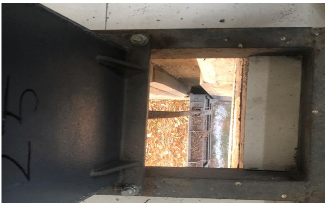
启闭设备现状
