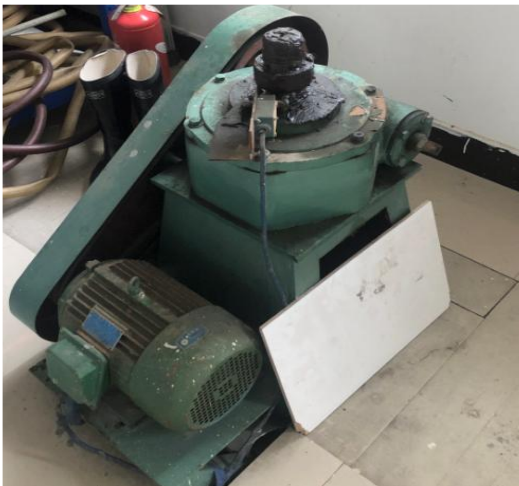
启闭设备现状
